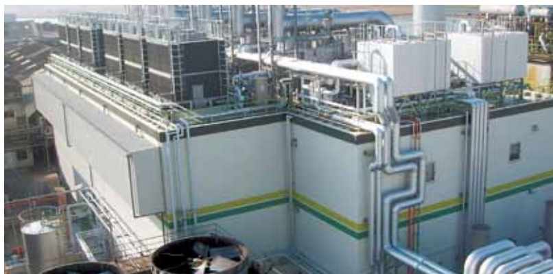
味の素(株)川崎事業所内エネルギー供給プラント
