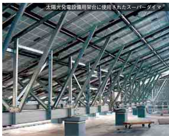
太陽光発電設備用架台に使用されたスーパーダイマ®
