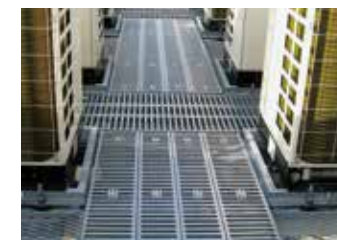
機器周辺作業・点検床
