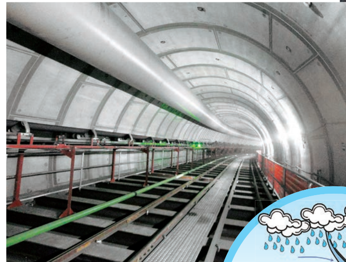
古川地下調節池
