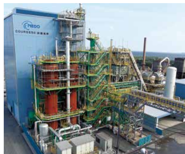
COURSE50 試験高炉外観 NEDO・日本鉄鋼連盟・COURSE50
