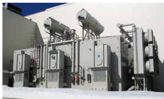
変換用変圧器
