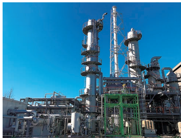
ESCAP®2号機(愛媛県新居浜市)
