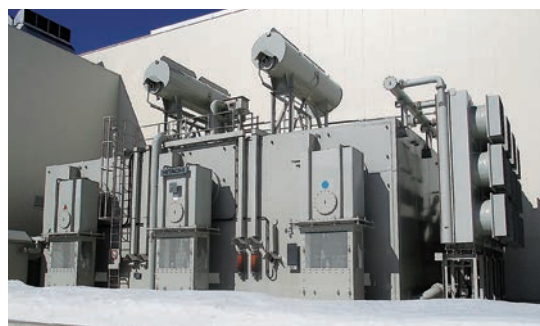
変換用変圧器
