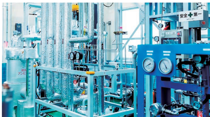
つばめBHB(株)の建設したパイロットプラント。すでに1年以上連続稼働している
