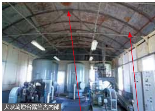
犬吠埼燈台霧笛舎内部
