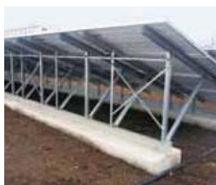
太陽光発電設備用架台使用例 「館林ソーラーパーク」(JAG国際航業グループ提供)
