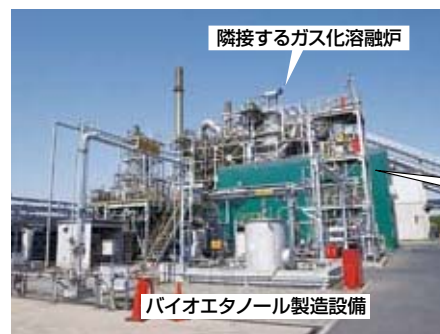
写真1 実証設備全景
