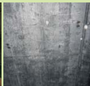
信濃町トンネル補修前の 天井部ひび割れ状況
