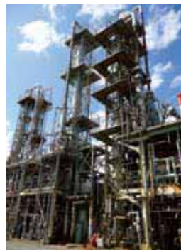
ジビニルベンゼン製造設備
