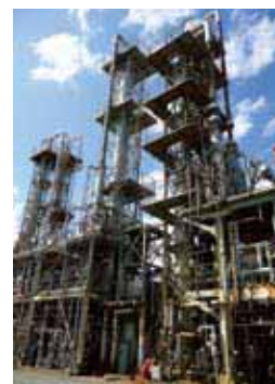
ジビニルベンゼン製造設備
