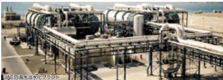
UAEの海水淡水化プラント
