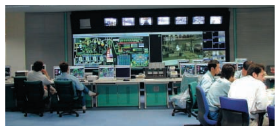
写真2 従来と更新後の中央監視室
