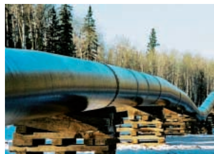
写真2 パイプライン
