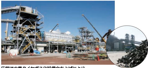
広畑での廃タイヤガス化設備立ち上げにより、日本全国で発生する廃タイヤの約1割以上(12万トン/年)を処理する計画。
