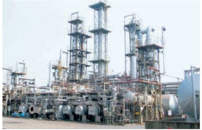
ジビニルベンゼン製造設備
