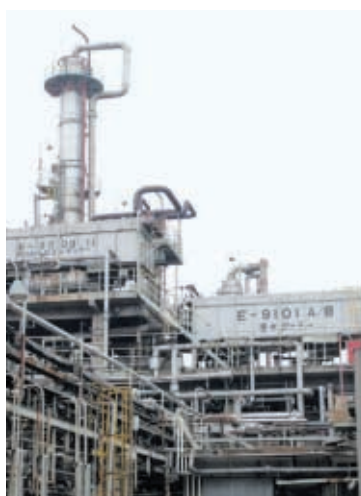
タール蒸留設備
