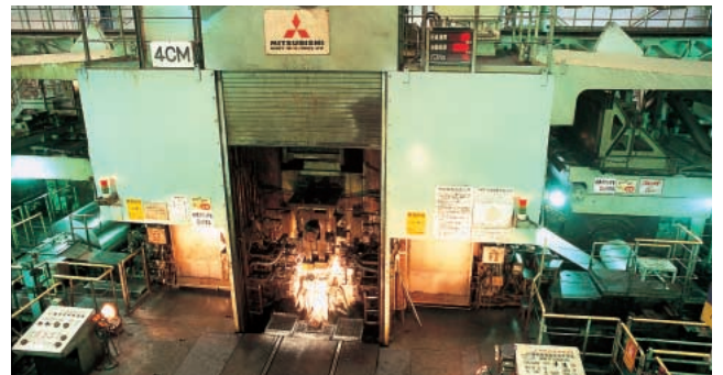
光製造所 薄板工場 / NO.4冷間圧延機
