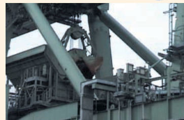
無動力集塵フードを備えたアンローダホッパー (鉄鉱石荷揚げ風景)
