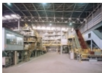
八幡のプラスチックリサイクル設備
