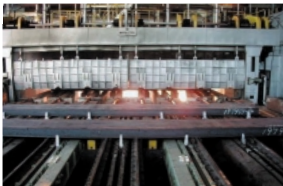
エネルギー効率の高いリジネバーナー方式の加熱炉
