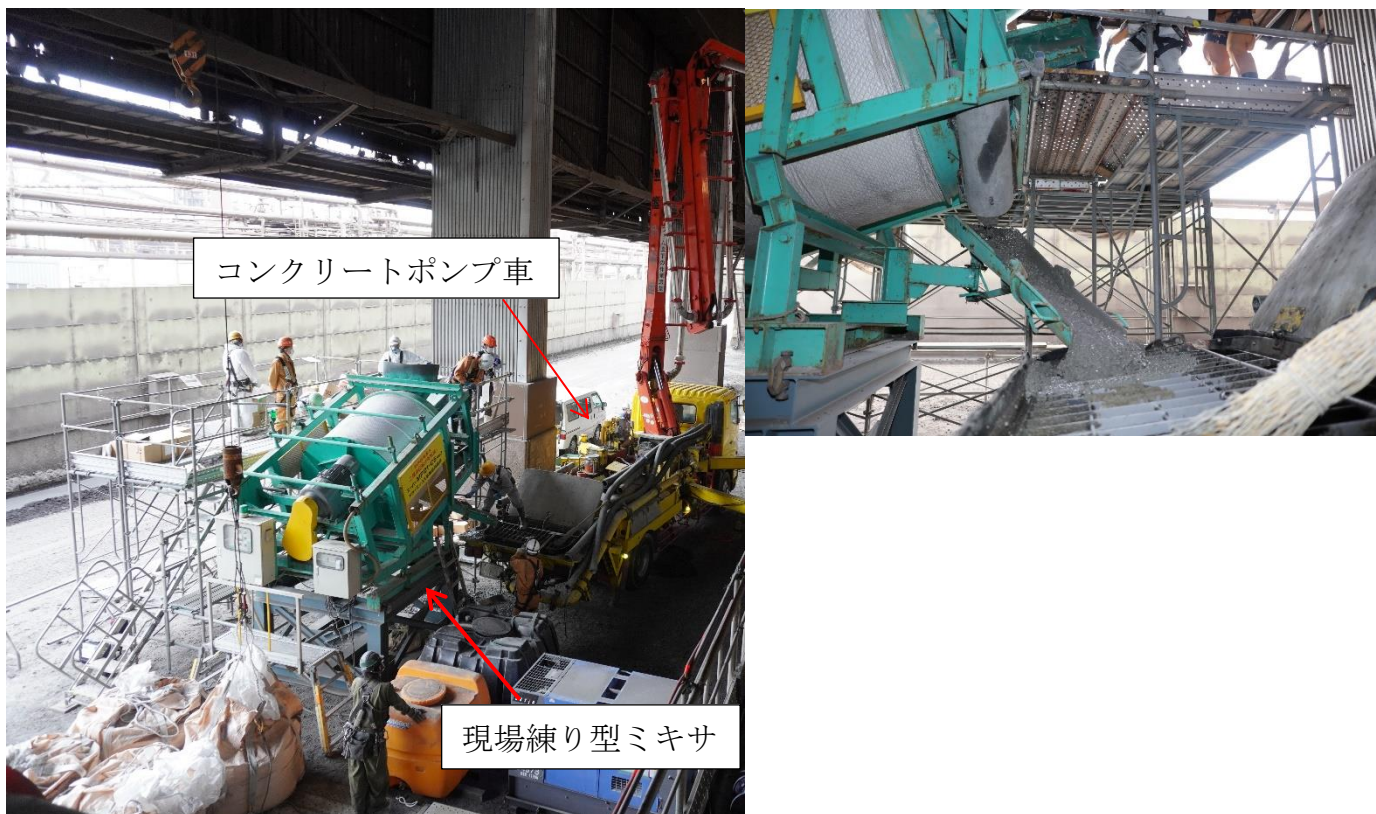
写真2 現場練り型ミキサから排出されるジオポリマーコンクリート
