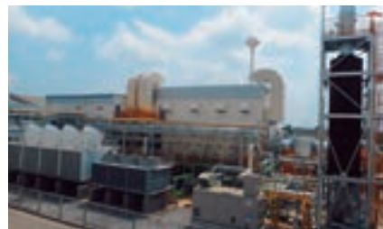
高効率コージェネレーション設備外観
