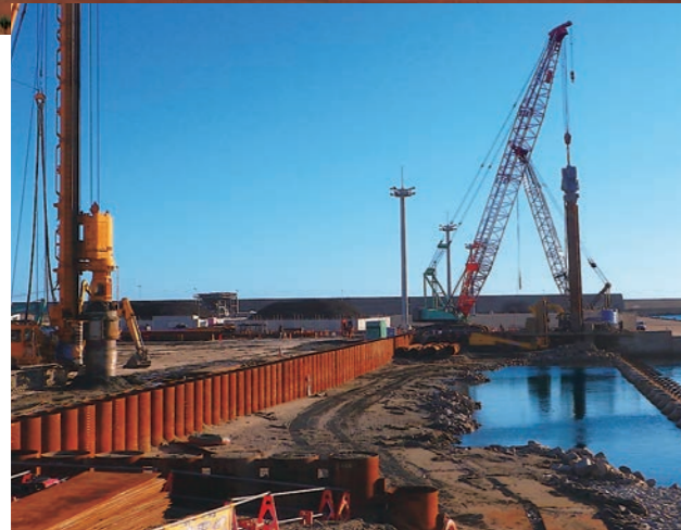
鋼管矢板による港湾護岸の施工状況 写真提供：東洋・本間特定建設工事共同企業体
