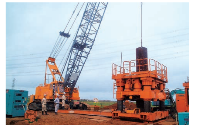
NSエコパイル®による送電線鉄塔の基礎工事状況 写真提供：東洋テクノ(株)
