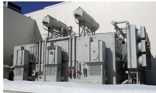
変換用変圧器
