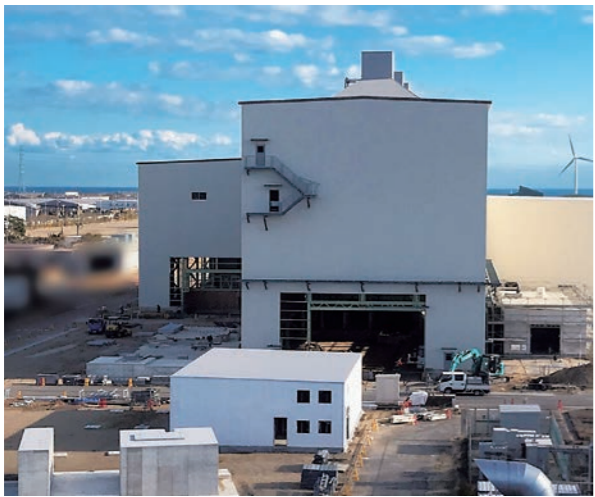
試験炉の運用開始を目指し着々と建設が進む 出典元: NEDO 製鉄プロセスにおける水素活用プロジェクト
